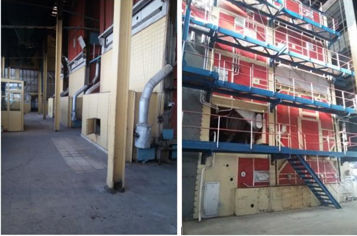
Şekil 3.2 Kazan dairesinin önden ve yandan görünüşü.
