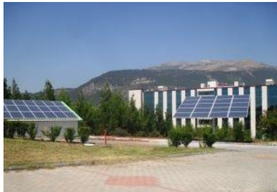
Şekil 1. Kahramanmaraş Sütçü İmam Üniversitesi, Avşar Kampüsü Güneş Paneli İstasyonu.
