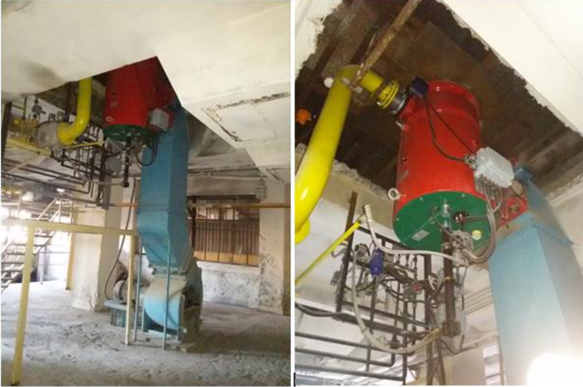
Şekil 3.3 Kazanı besleyen brülörler ve yanma havası kanalı. brülör kazana alttan bağlanmaktadır.
